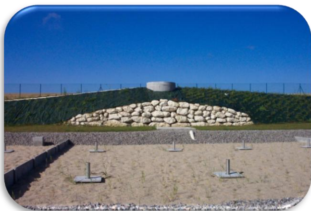
Station de Clion sur Seugne 300 EH de type filtres plantés de roseaux
