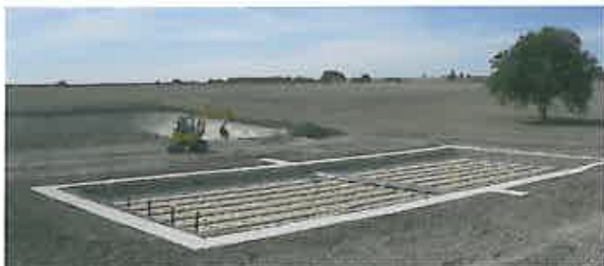
COLOMBIERS « lits plantés de roseaux » 350 équivalent habitants Montant opération 325 000 € HT
