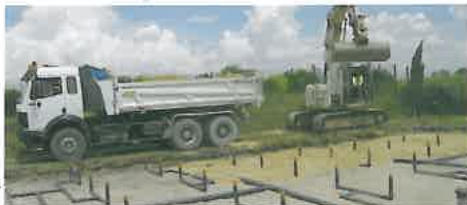
SOULLIGNONNES Extension de la station du bourg « Lits plantés de roseaux » 280 équivalent habitants Montant opération 88 000 € HT
