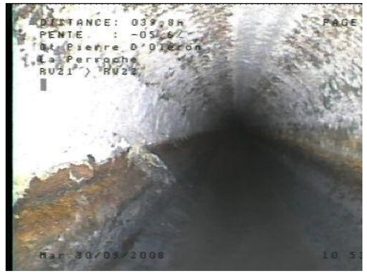
Corrosion en voûte
