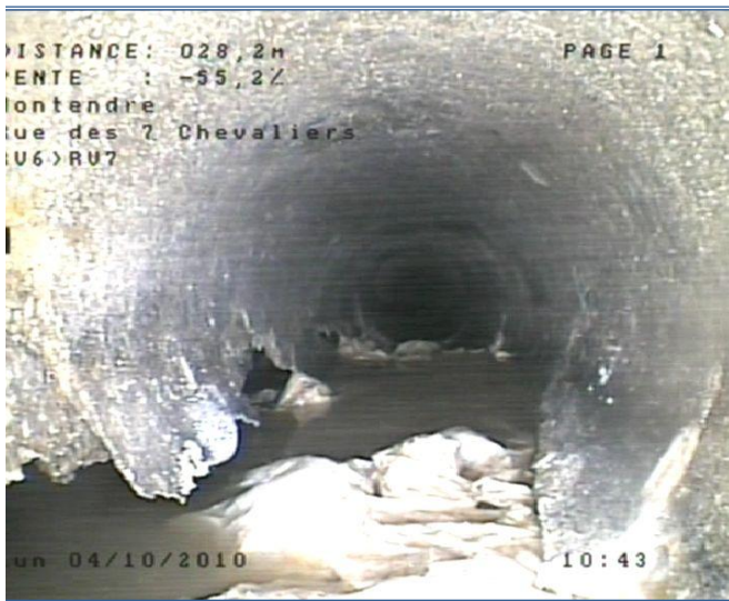
Corrosion du radier
