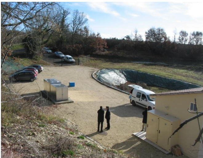
Captage de Léoville "Métairie de Puyrigaud" réception des installations
