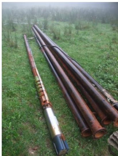
Sortie de la pompe et de la colonne d'exhaure du forage
